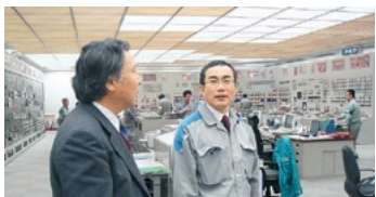
各施設・設備のすべてのデータを24時間体制でチェックする中央制御室。表示パネルや運転員の仕事ぶりを丹念に見て回る
